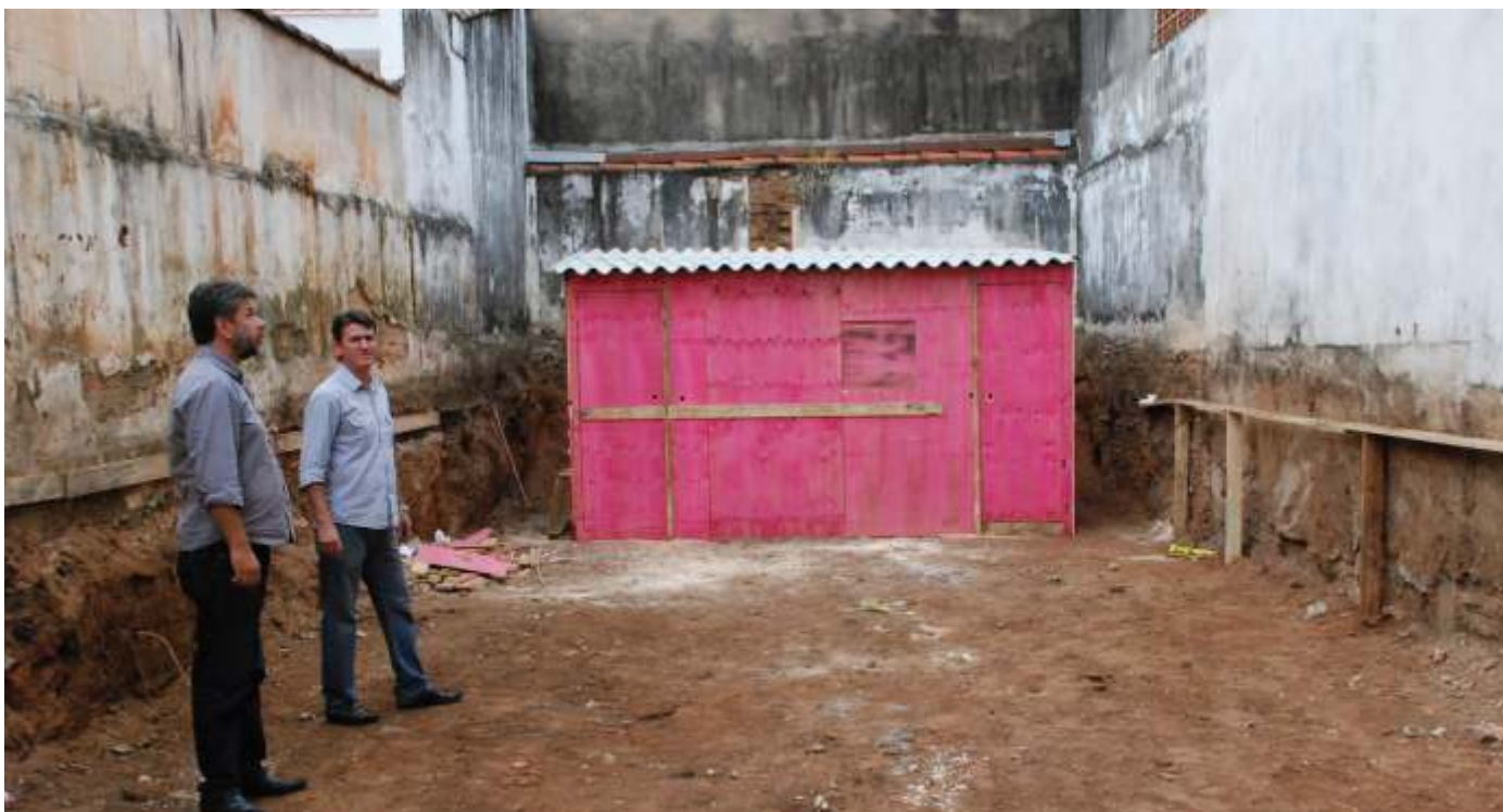
O Presidente do Sindiquinze, Zé Aristéia, e o Gerente do sindicato, Edvaldo Landgraf, acompanham o primeiro dia das obras de ampliação e modernização da sede do Sindiquinze; ao fundo, depósito de materiais e um banheiro foram construídos
